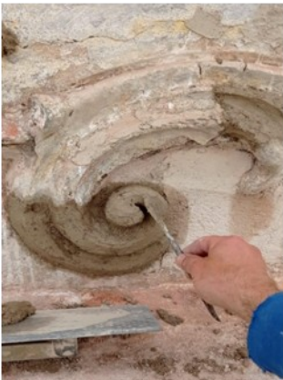
la messa in sicurezza degli intonaci storici crollati o mancanti.
